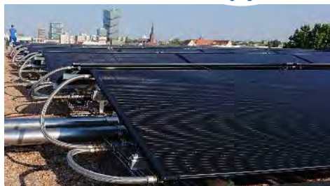
Solarenergie mit PVT
