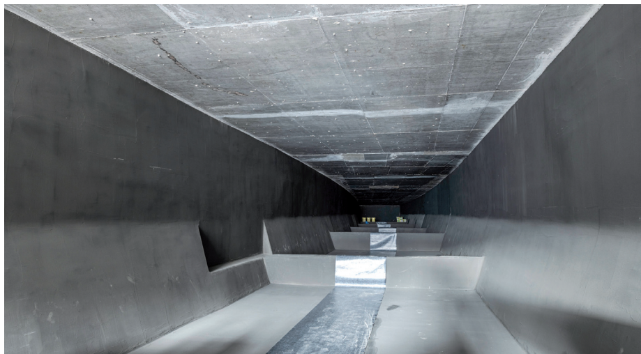
Der Eisspeicher mit 1.500 m 3 Fassungsvermögen als Saisonspeicher.
